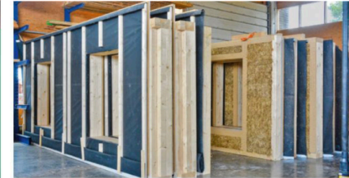
Fertig zum Abtransport: Wandmodule, die außen noch mit Holz verschalt und innen vier Zentimeter dick mit Lehm verputzt werden.
