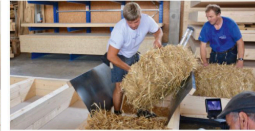
Strohballeneinbau in der Zimmerei Holzbau Bogner. Die Ballen werden in die Wandmodule aus klostereigenem Holz gefügt.
